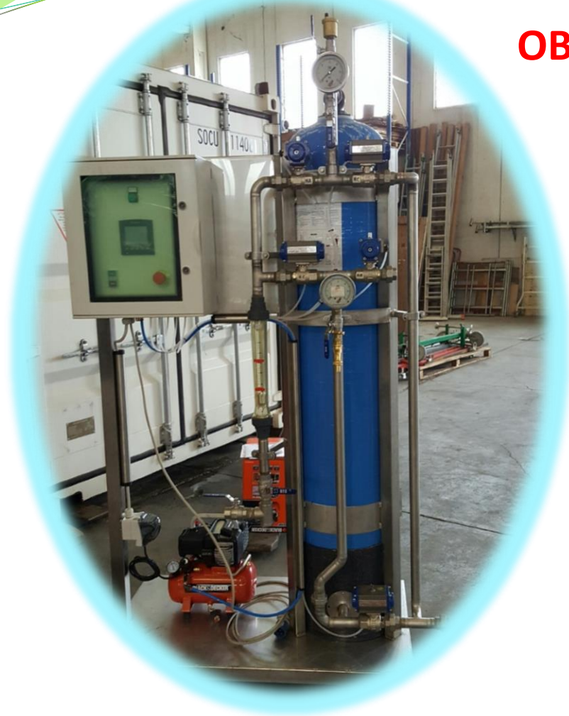
Collaudo in sede OB ad Orzinuovi (BS)
